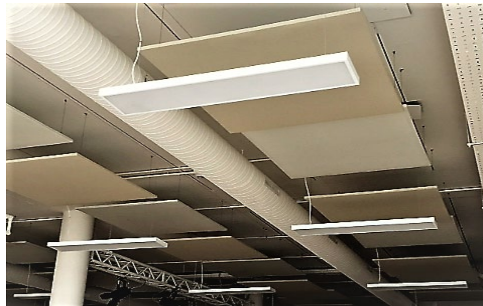
Particolare pannelli fonoassorbenti - Gadames 57
